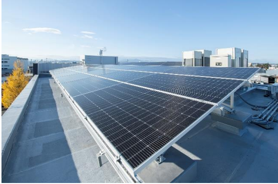
太陽光発電設備
